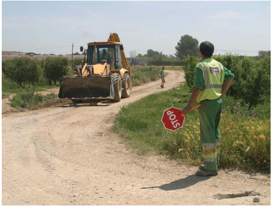
Les obres d'arranjament dels vials de l'Horta han començat al final de maig.
