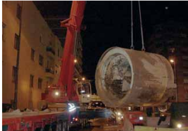
El nou equipament transporta i aboca les aigües residuals i pluvials.
