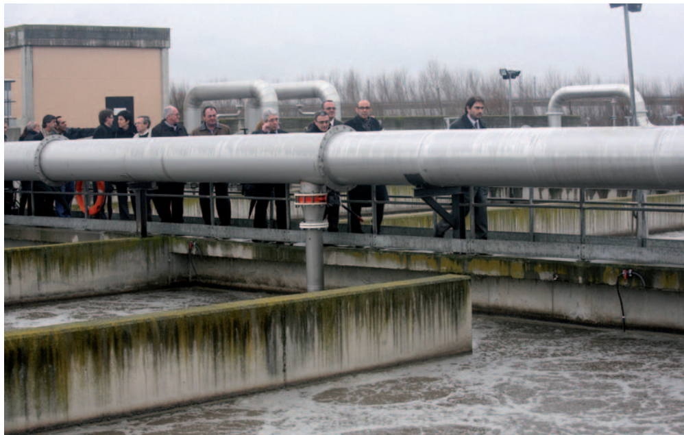
LA DEPURADORA POT TRACTAR FINS A 96.000 M 3 D'AIGUA PER DIA. © H. S.
