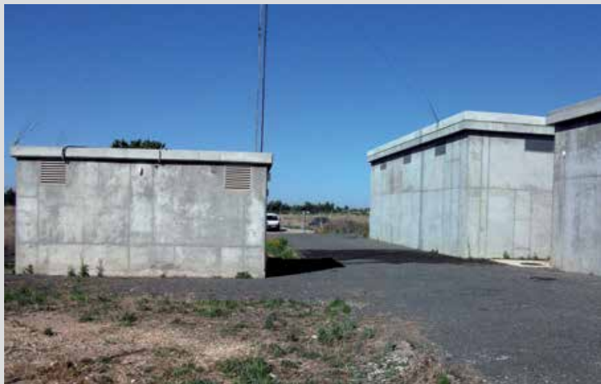
Les noves instal·lacions garantirán el proveïment per als propers 50 anys. © Aigües de Lleida
