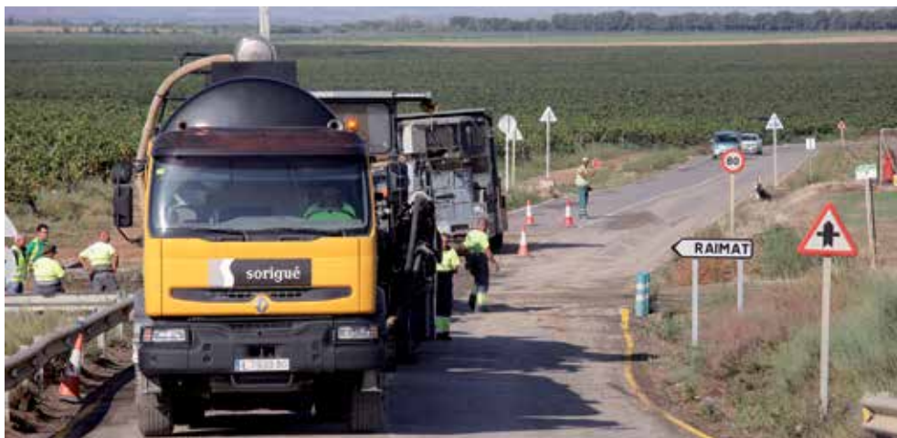
L'actuació s'ha fet des de la cruïlla de la N-240 fins a l'accés a Raimat. © Hermínia Sirvent
