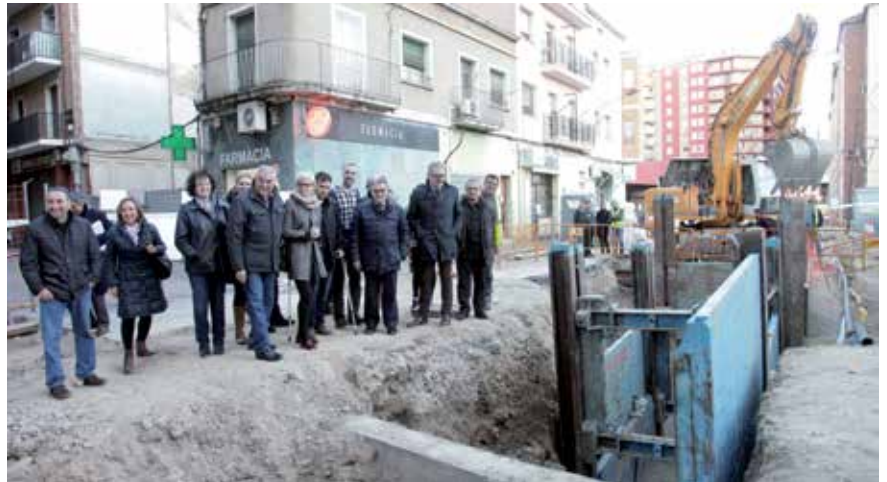
Les obres permeten acabar amb les inundacions i millorar la xarxa d'aigua potable. © H. S.
