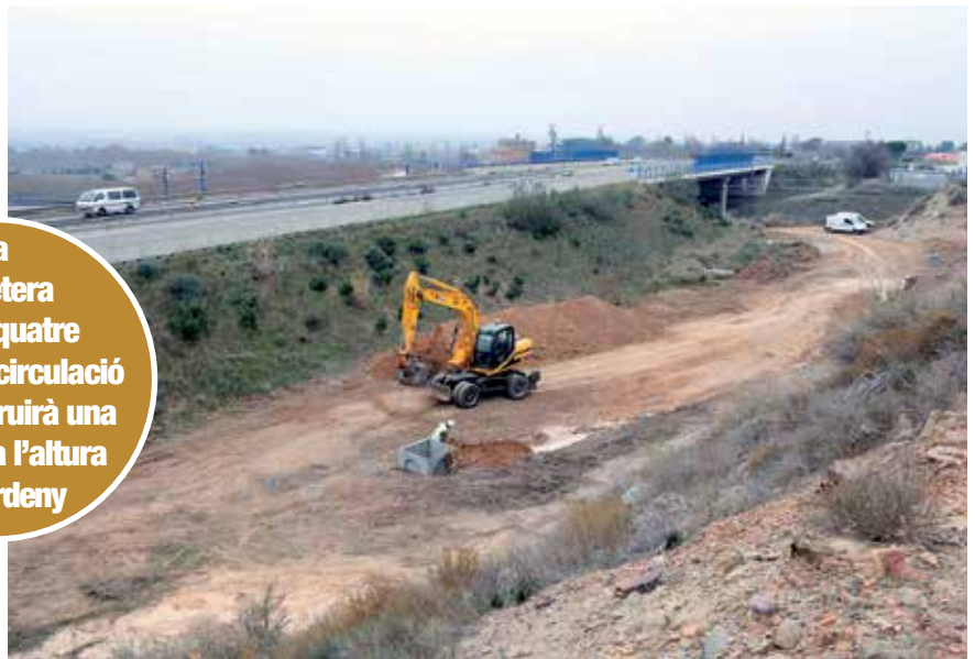
Les obres de millora de l'accés a Lleida es van iniciar a mitjan desembre del 2015. © H. Sirvent
