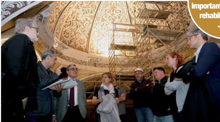
L'actuació ha permès millorar de la volta creuer del temple. © H. Sirvent
