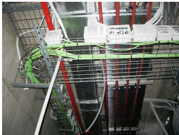
Vista instal·lacions sostre.
