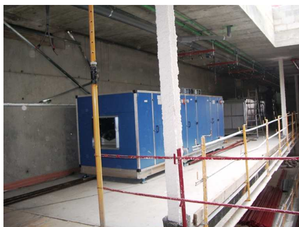
Sala instal·lacions T.05.054
