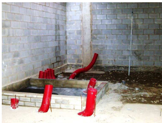
Sala transformador electricitat
