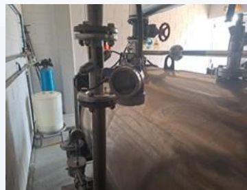
Caudalímetre biogas caldera
